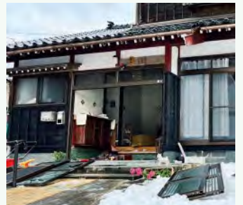
自宅の崩壊した玄関
